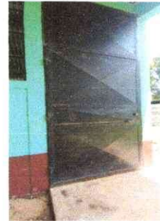
Foto 2: LA PUERTA ESTA EN MAL ESTADO, LAS PINTURAS YA SE ESTAN SALIENDO, SE NECESITA UN BUEN MANTENIMIENTO
