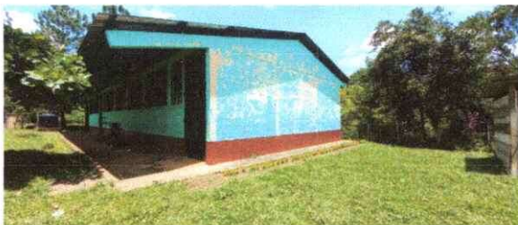
Foto 5: LA ESCUELA NECESITA UNA PINTADA
