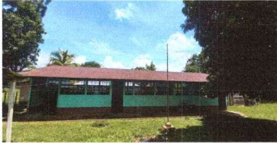
Foto 1: LA CUBIERTA DE LAMINA DE LA EORM CASERIO LOS ENCUENTROS ESTÁ EN MUY MAL ESTADO
