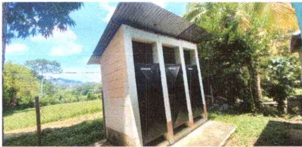
Foto 3: EL SANITARIO LAS LAMINAS ESTAN OXIDADAS Y CASI SE CAEN, LAS COSTANERAS HAY CAMBIAR.
