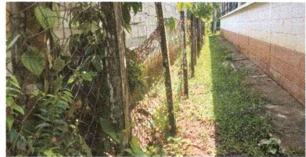
Foto 4: EL CERCO DE LA ESCUELA ESTA EN MAL ESTADO HAY REMODELAR
